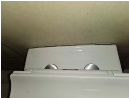
Elastiske fuger rundt toalett har manglende vedheft.
