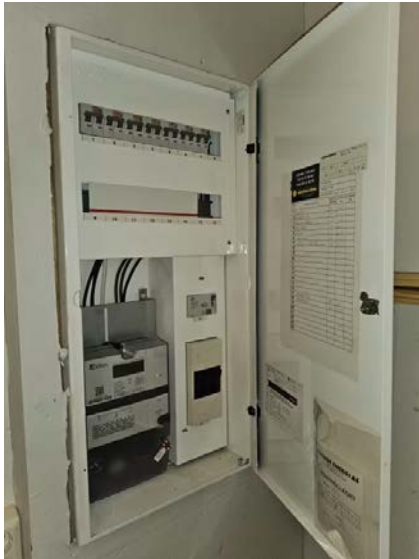
Sikringsskap er plassert i bod.
