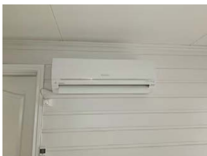
Varmepumpe er plassert i stue.
