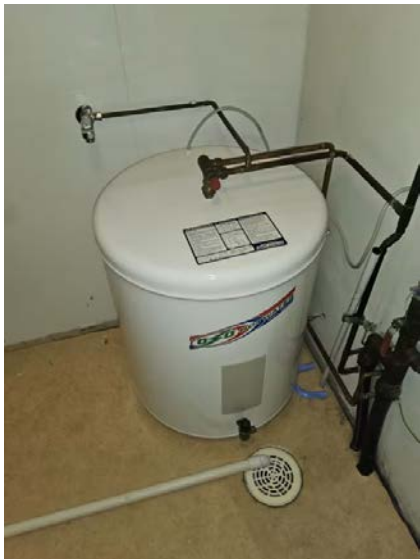
Varmtvannsbereder er plassert i bod.
