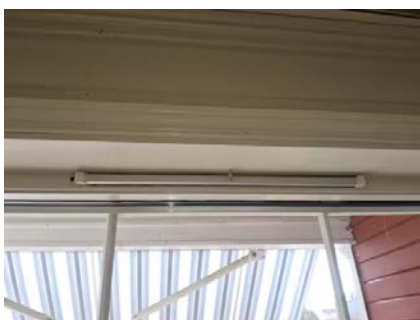
Naturlig ventilasjon fra spalteventiler i vinduer.
