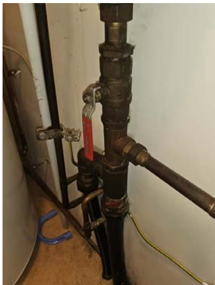
Hovedstoppekran er plassert på bod.
