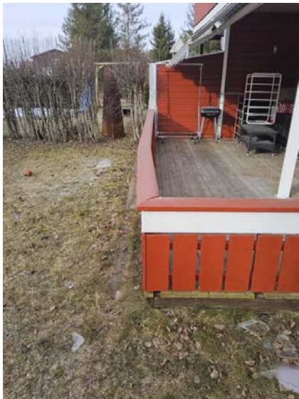
Bilde viser skjevheter i rekkverk.
