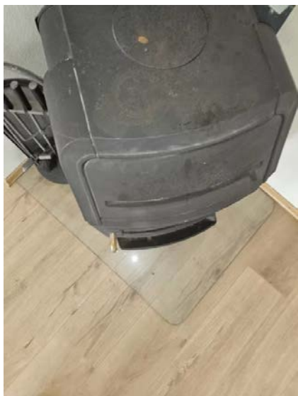
Ubrennbar plate oppfyller ikke minstekravet.
