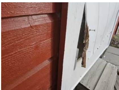
Dør til sportsbod bærer preg av skader/slitasje.
