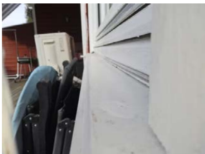
Det registreres vannbord/beslag uten fall.
