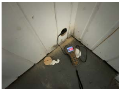
Ved hulltaking så ble det målt skadelig fukt.
