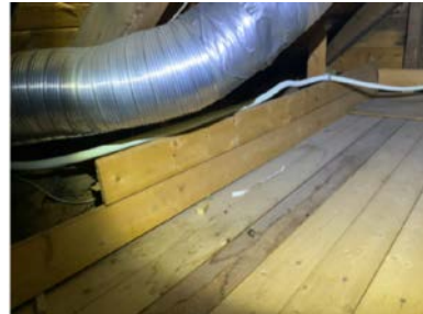
Fuktmerker ved avtrekksrør.
