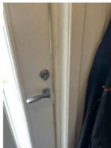
Ytterdør til plan 1 er utett mellom dørblad og karm.
