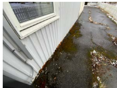
Mangler vindusbeslag på enkelte vinduer.
