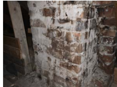
Rennemerker på pipe observert på loft.
