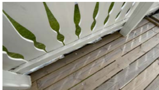
Mangelfull utførelse på beslag.
