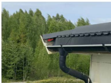
Råteskader på vindskibord mot vest.
