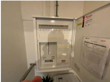
Sikringsskap i 2. etasje.
