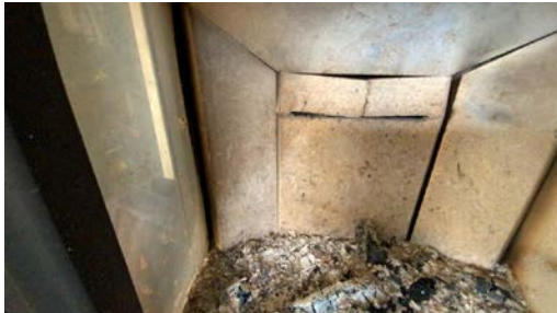
Sprekk i ildfast stein.
