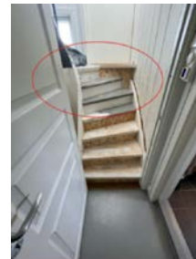
Mangler repos på trapp fra inngangdør til 2 etasje.
