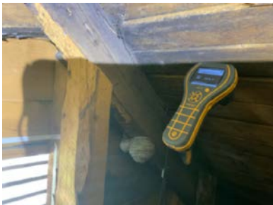
Synlig misfarging på taktro.
