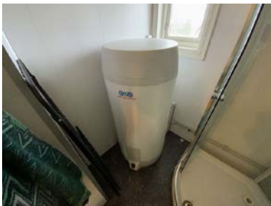
Varmtvannsbereder på bad i 2.etasje.
