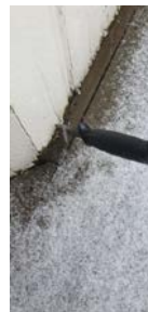
Det er påvist spredte råteskader i bordkledningen.
