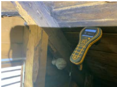
Synlig misfarging på taktro.
