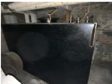
Oljetank montert i kjeller.
