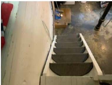
Det er ikke montert rekkverk ned til kjeller.
