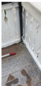
Det er påvist fukt/råteskader i konstruksjonen.
