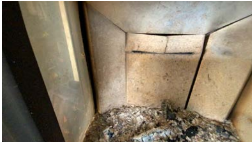
Sprekk i ildfast stein.
