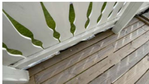
Mangelfull utførelse på beslag.
