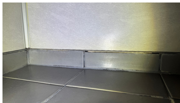
Manglende fug mellom bunnlist og baderomsplater.
