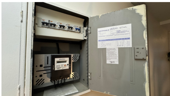
Kontroll av el-skap og kursfortegnelse.
