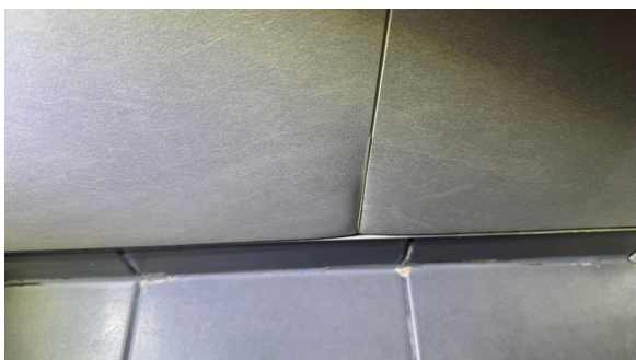
Det er registrert fuktsvell i nedkant av baderomsplater i dusjsonen.
