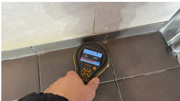
Det ble målt forhøyede fuktverdier.
