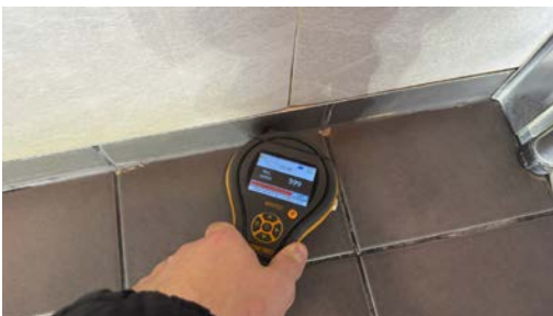
Det ble målt forhøyede fuktverdier.
