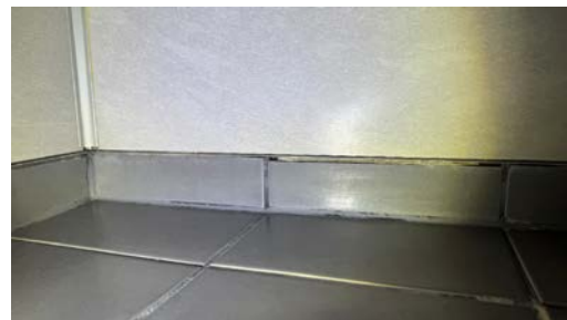
Manglende fug mellom bunnlist og baderomsplater.
