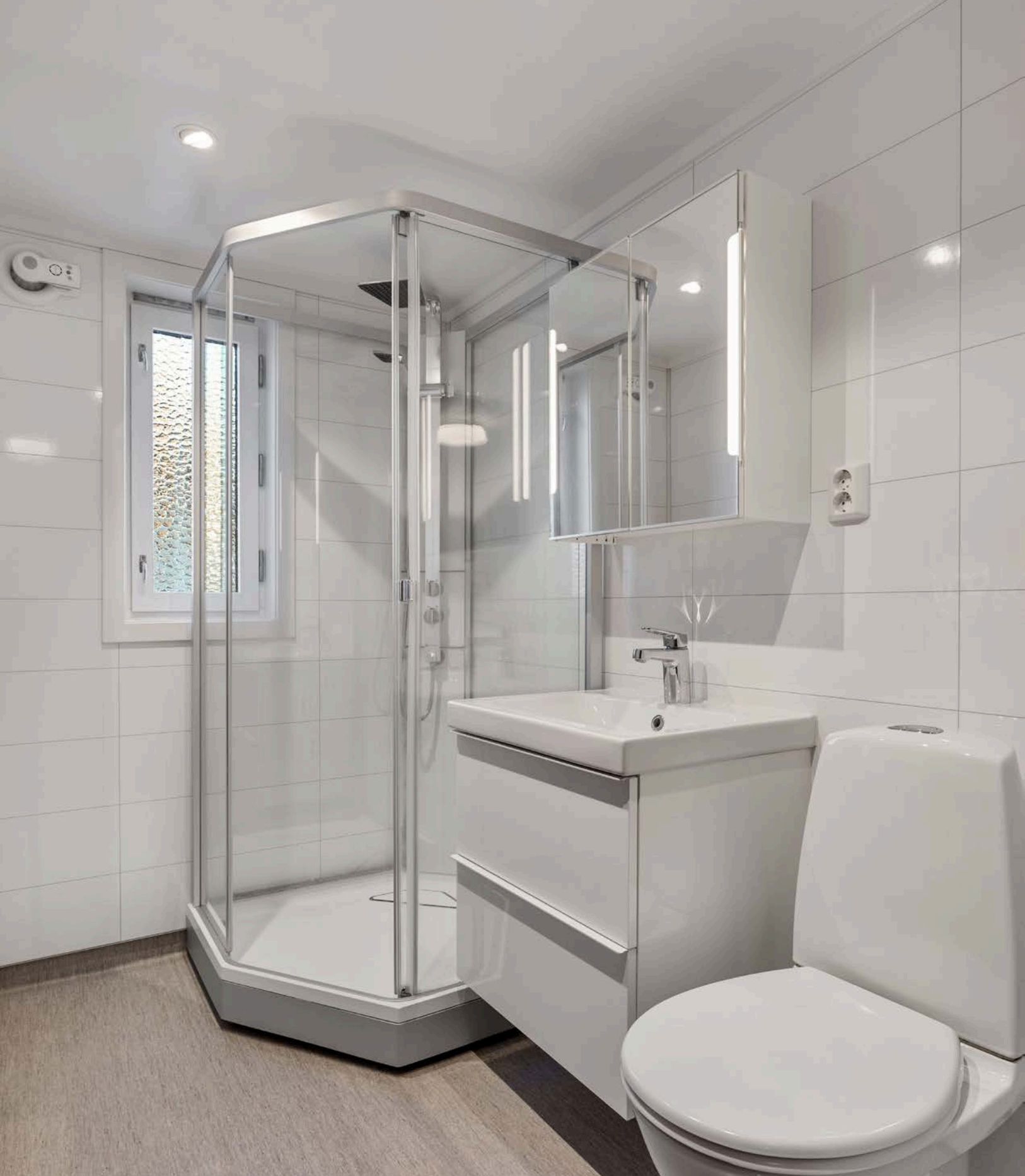
Baderom i 2. etasje som ble pusset opp av firma i 2017. Baderommet er utstyrt med servantskap, speilskap med integrert belysning, dusjkabinett og gulvstående toalett.
