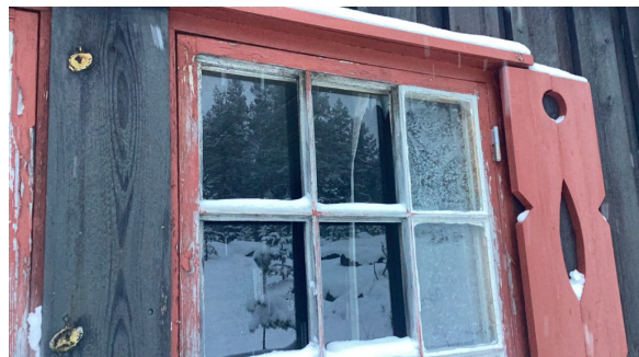
Vindu i stue mangler flere utvendige glass.
