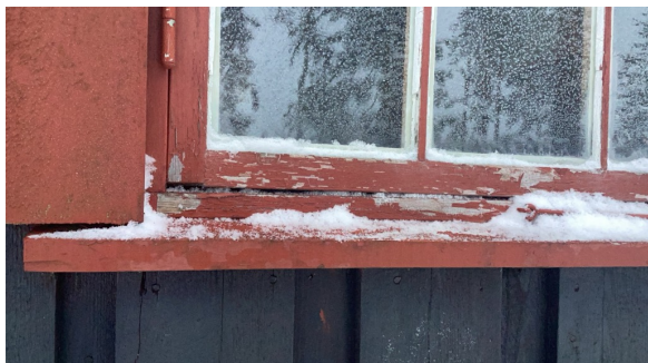
Eksempel på slitasje.
