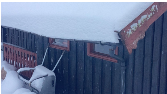
Taknedløp har løsnet fra takrenne.
