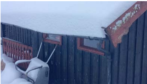
Taknedløp har løsnet fra takrenne.
