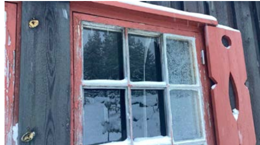
Vindu i stue mangler flere utvendige glass.
