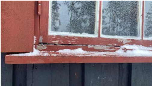
Eksempel på slitasje.
