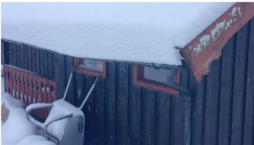
Taknedløp har løsnet fra takrenne.
