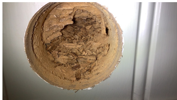
Det er tørre råteskader i tømmer i delevegg.
