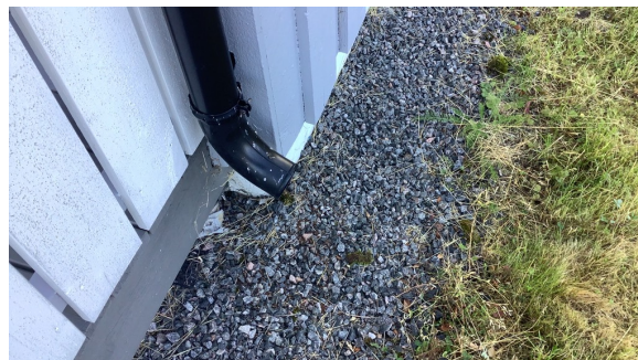
Eksempel på mangelfull bortledning av takvann.
