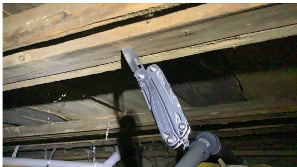
Trebjelke er våt og myk på befaringsdagen.
