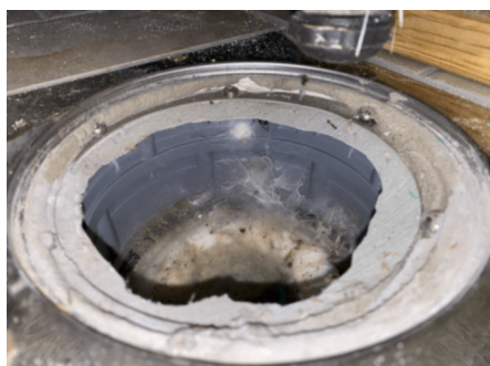
Plastsluk, og slukmansjett er ført under slukets klemring.
