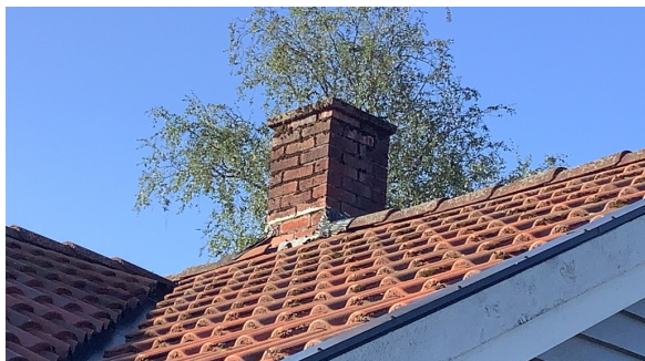
Det mangler overgangsbeslag på deler av pipe.
