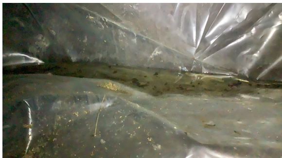
Vann på fuktsperre på grunnen i krypkjeller.
