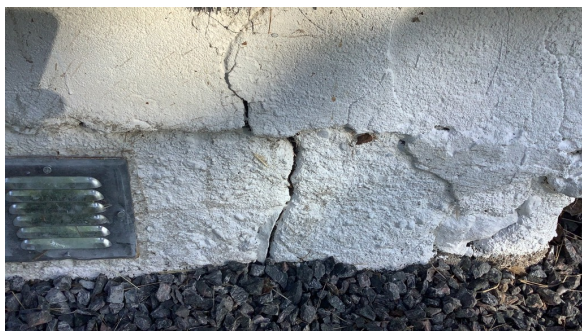
Sprekkdannelse og grov utførelse.
