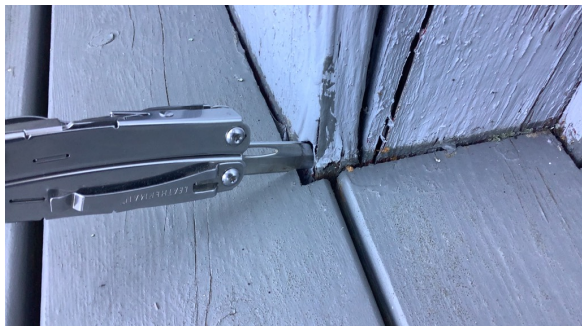
Eksempel på råteskade.
