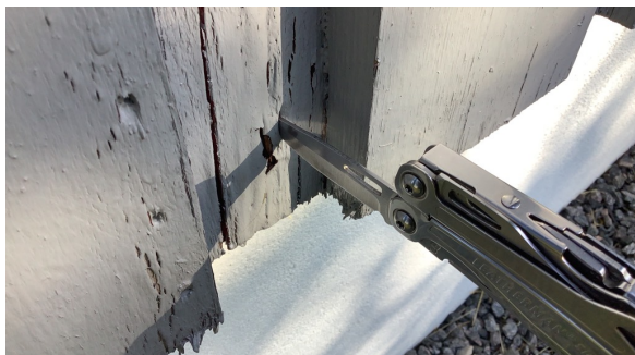
Eksempel på råteskade.
