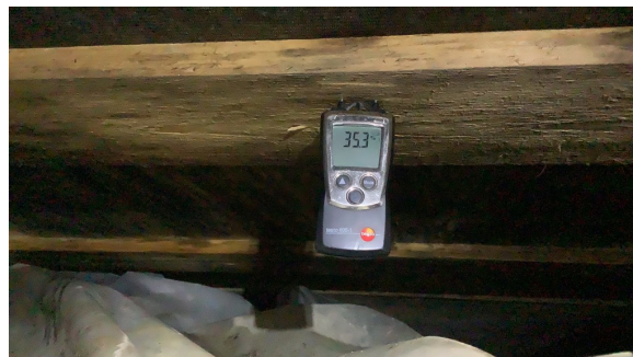
Gulvbjelke er våt (mer enn 28 vektprosent fuktinnhold).
