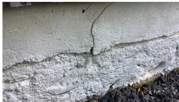
Sprekkdannelse og grov utførelse.
