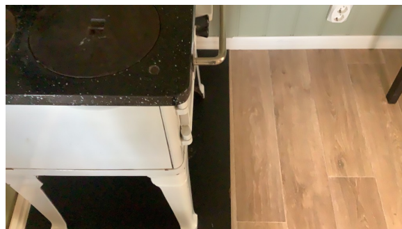
Mangelfull størrelse på ubrennbar plate foran kjøkkenovn.
