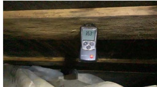
Gulvbjelke er våt (mer enn 28 vektprosent fuktinnhold).
