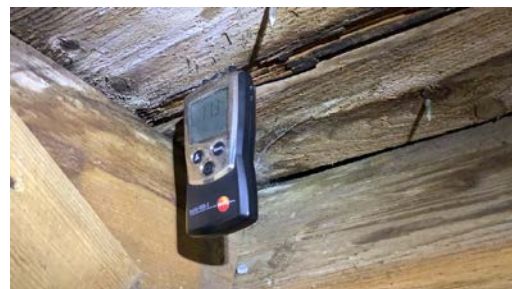
Fuktmåling i råteskadet taktro ved pipe, og det måles tørt på befaringsdagen.
