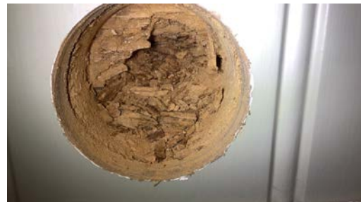
Det er tørre råteskader i tømmer i delevegg.
