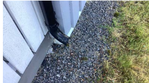
Eksempel på mangelfull bortledning av takvann.
