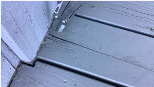
Eksempel på råteskadet terrassebord.
