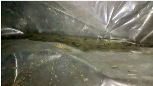
Vann på fuktsperre på grunnen i krypkjeller.
