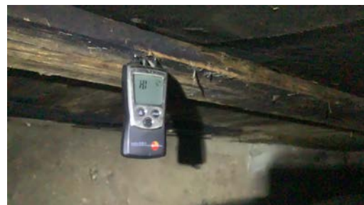
Fuktmåling, og treverk er vått (mer enn 28 vektprosent fuktinnhold).
