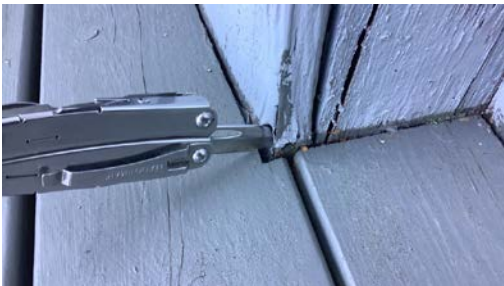
Eksempel på råteskade.
