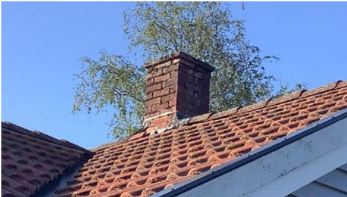
Det mangler overgangsbeslag på deler av pipe.
