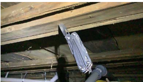
Trebjelke er våt og myk på befaringsdagen.
