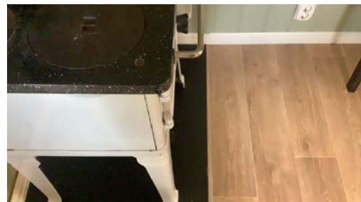
Mangelfull størrelse på ubrennbar plate foran kjøkkenovn.
