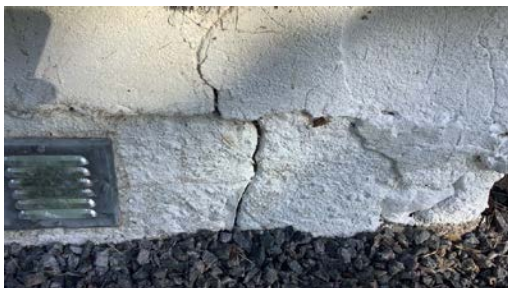
Sprekkdannelse og grov utførelse.
