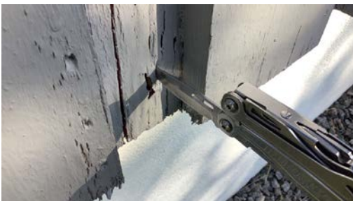
Eksempel på råteskade.
