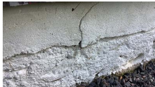
Sprekkdannelse og grov utførelse.
