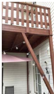
Rekkverk på veranda 2 etg for lavt iht dagens krav
