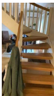
Mangler håndløper nederste del
