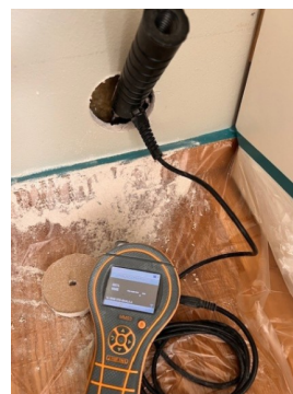
Fuktmåling i vegg mot våtsone.
