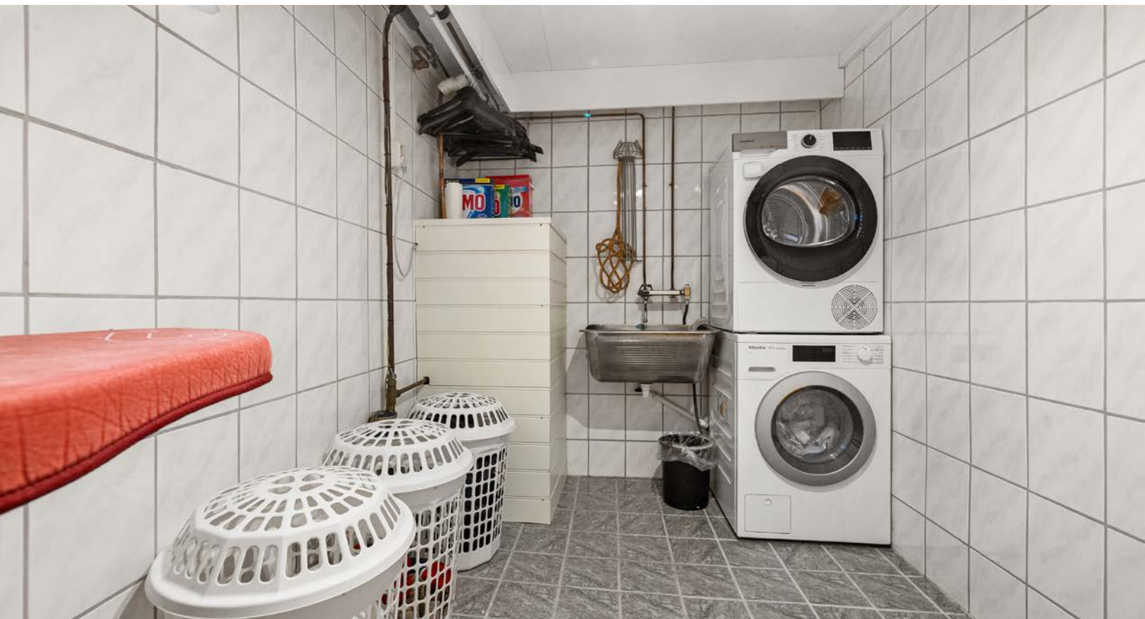
Meget praktisk vaskerom i kjelleren med flislagte overflater. Innredet med skyllekum og opplegg for vaskemaskin og tørketrommel.
