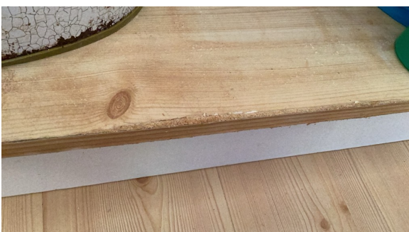
Svelling i benk etter vannlekkasje.
