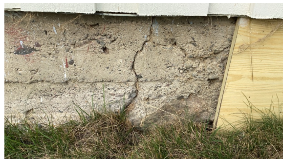
Eksempel på utvendig sprekk.
