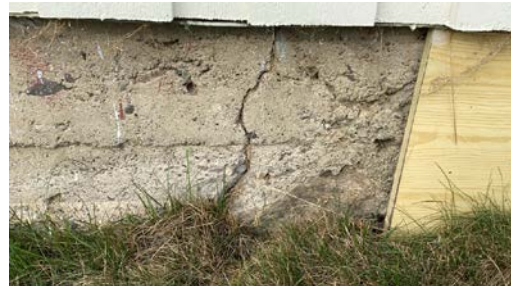
Eksempel på utvendig sprekk.
