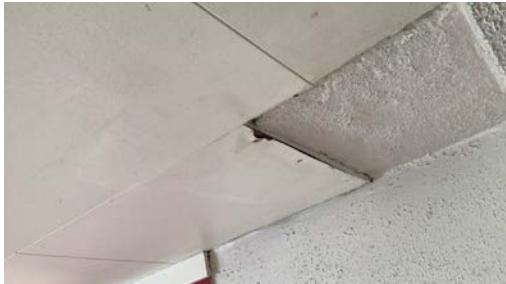
Fuktmerker i himling på kjøkken.
