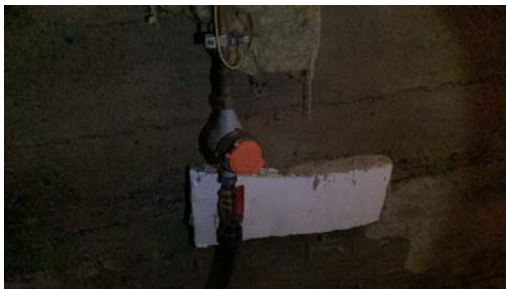
Vanninntak med måler og stoppekran i kjeller.
