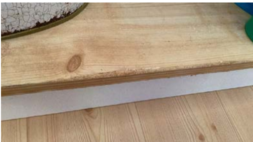
Svelling i benk etter vannlekkasje.
