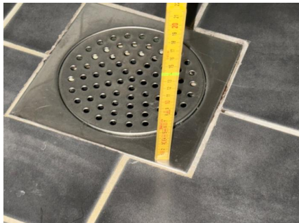
Fallforhold ca. 140 mm topp slukrist i dusjsone
