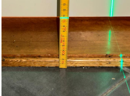
Fallforhold ca. 106 mm overkant gulv ved terskel
