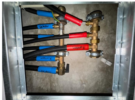
Vannfordeling i himling på bad/wc
