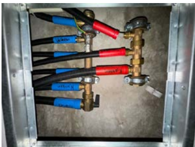
Vannfordeling i himling på bad/wc
