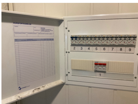
Sikringsskap i teknisk rom
