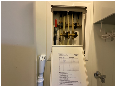
Rør i rørskap i teknisk rom
