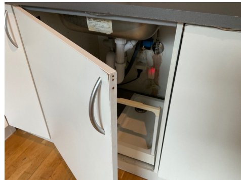
Fuktskadet kjøkken fronter og kjøkkenskap
