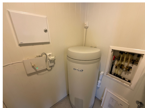
Varmtvannstank i teknisk rom
