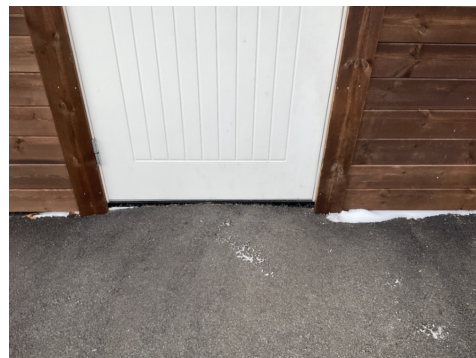
Trepanel ned mot asfalt ved inngangsparti
