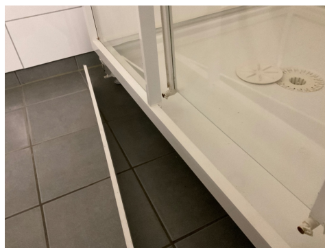
Knekt feste på skyvedør i dusjkabinett
