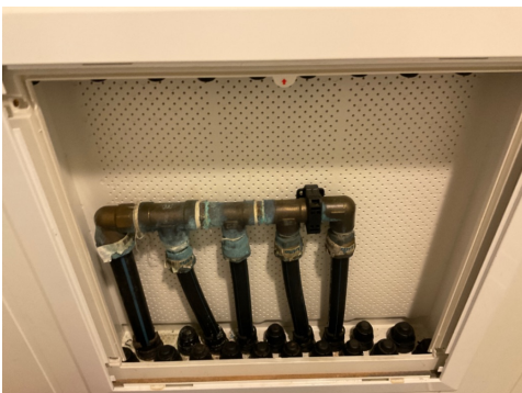
Fordelerskap for vannledninger
