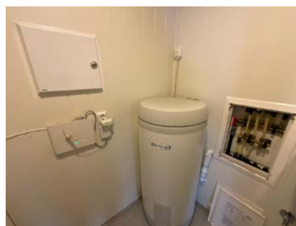
Varmtvannstank i teknisk rom
