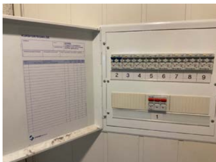
Sikringsskap i teknisk rom
