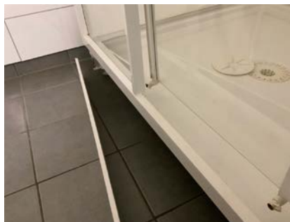
Knekt feste på skyvedør i dusjkabinett
