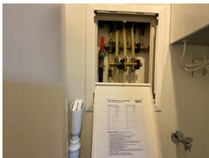
Rør i rørskap i teknisk rom
