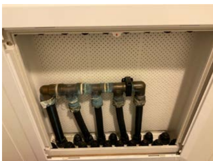
Fordelerskap for vannledninger
