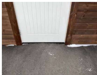
Trepanel ned mot asfalt ved inngangsparti
