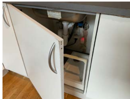
Fuktskadet kjøkken fronter og kjøkkenskap
