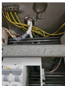
Utett gjennomføring i sikringsskapet
