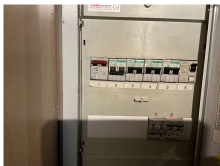
Automatsikringer i sikringskap plassert i entre.
