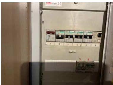
Automatsikringer i sikringsskap plassert i entre.
