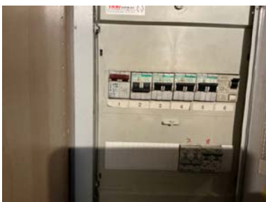
Automatsikringer i sikringsskap plassert i entre.
