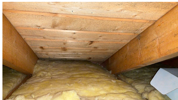
Lufting av skråtak er ikke ivaretatt. Enten er ikke lufting over skråtak etablert, eller så dekker isolasjon lufting.
