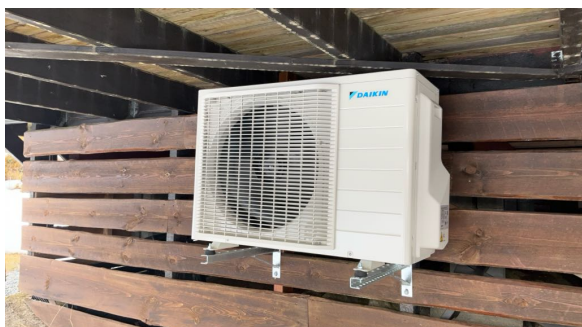
Varmepumpe luft-luft fra 2023.
