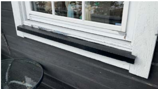
Værslitte karmen på vinduer utvendig.
