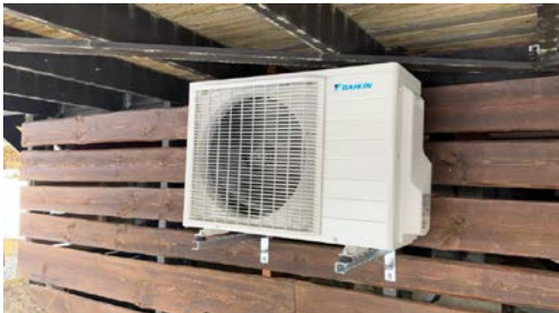
Varmepumpe luft-luft fra 2023.
