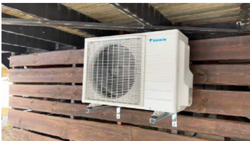
Varmepumpe luft-luft fra 2023.
