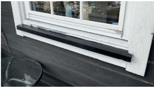
Værslitte karmen på vinduer utvendig.
