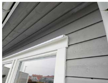
Manglende luftespalte for lufting av valgt takkonstruksjon.
