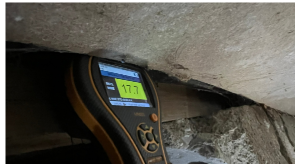
Fuktmålingen viser skaderlig fuktverdier.
