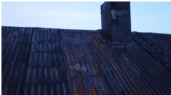
Rustdannelser og svekkelser på taktekingen.
