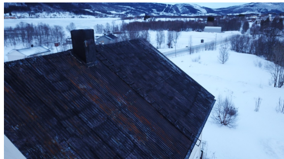
Rustdannelser og svekkelser på taktekingen.
