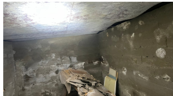
Fuktig overflate på grunnmuren.
