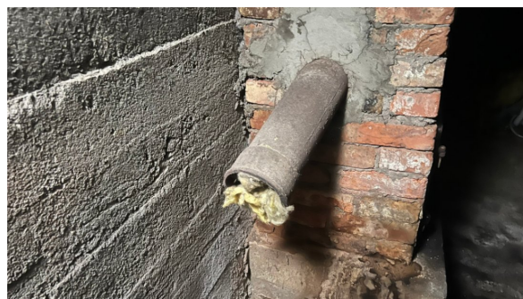
Røykrør som ikke er blendet i kjelleren.
