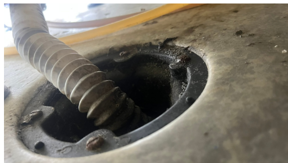
Sluk under dusjkabinett
