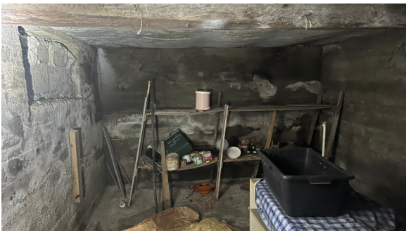
Viser kjelleren generelt og stubbloftet med soppdannelse spesielt.
