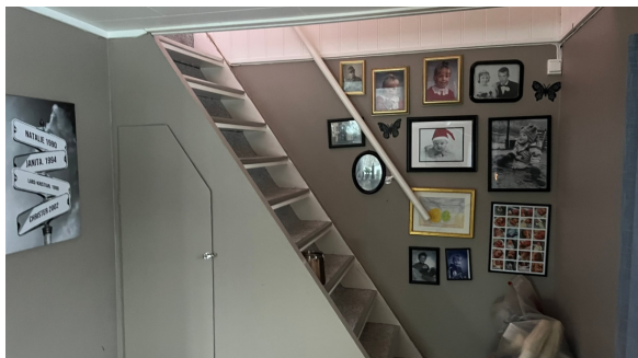
Trapp uten rekkverk.
