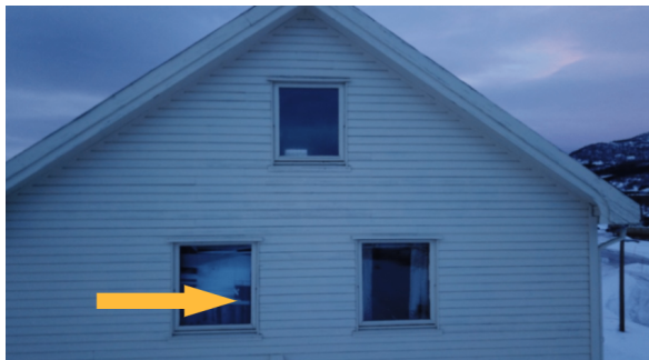
Eksempel på råteskadet vindu
