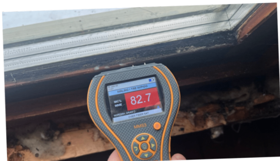
Fuktmåling i vidu på loftet
