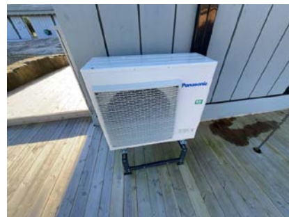
Varmepumpe, utvendig aggregat.
