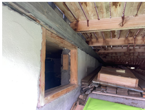
Synlige retningsavvik på mur under terrasse.
