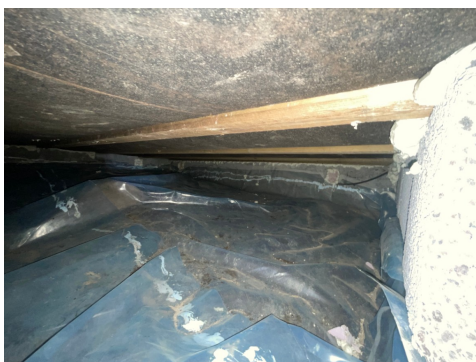
Ventiler er tettet igjen.
