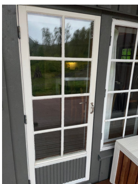
Værslitt/oppsprukket treverk utvendig.
