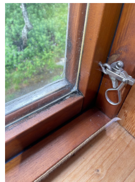
Synlig kondensering innvendig
