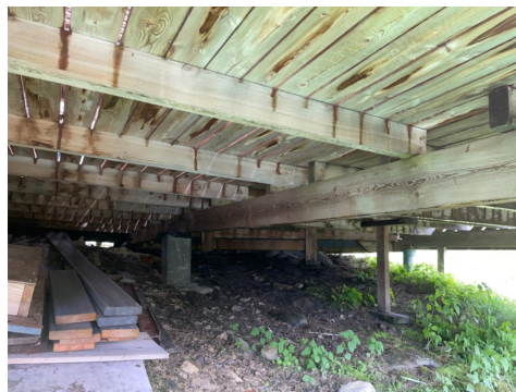
Stedvis ufaglig fundamentering.
