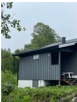
Synlige skjevheter i takkonstruksjon.
