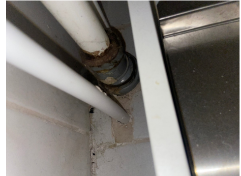
Rørgjennomføring i gulv med avvik
