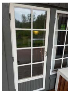
Værslitt/oppsprukket treverk utvendig.
