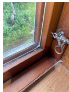
Synlig kondensering innvendig
