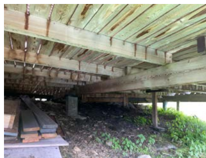
Stedvis ufaglig fundamentering.
