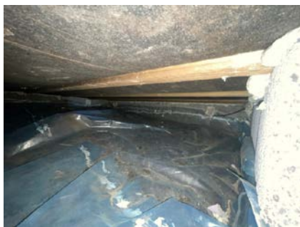
Ventiler er tettet igjen.
