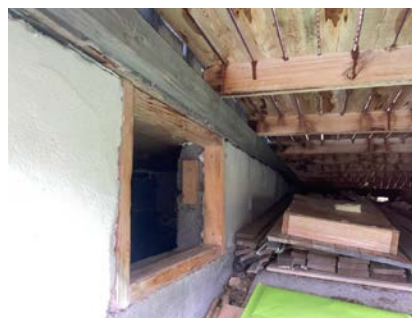
Synlige retningsavvik på mur under terrasse.
