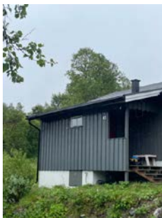
Synlige skeivheter i takkonstruksjon.
