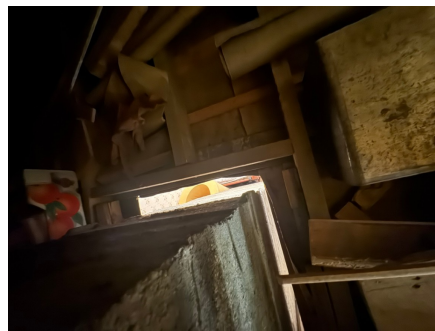
Åpninger rundt pipen.
