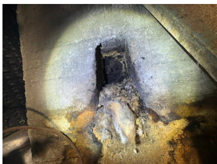
Det er ikke montert sotluke i pipen og sotluken må tømmes.
