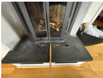
Det er ikke tilfredsstillende ubrennbar plate framfor ildstedet.
