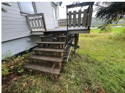
Det er ikke rekkverk i trappen.
