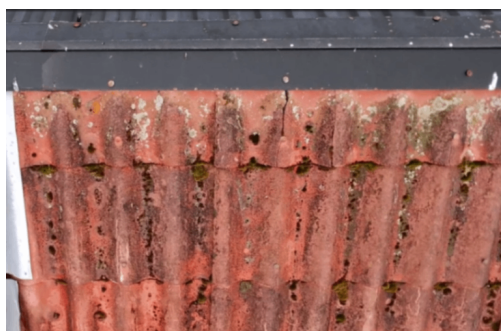
Sprekker i taktekingen.
