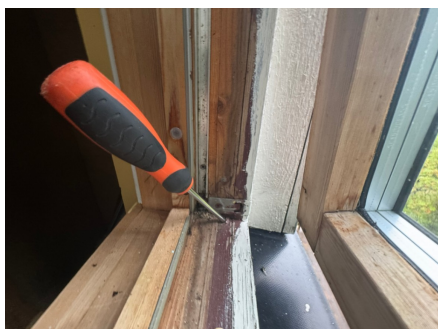
Råteskade i vinduet.
