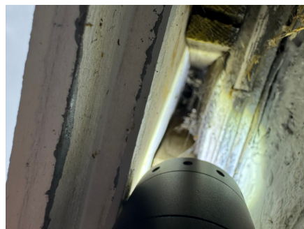
Det er ikke montert musesperre bak deler av kledningen.
