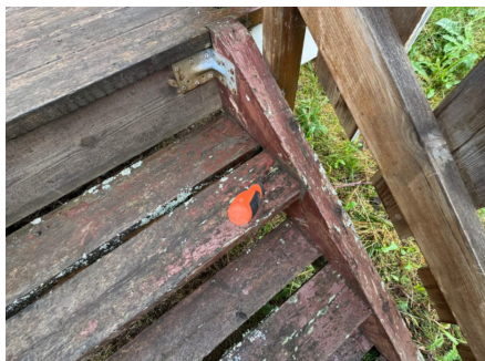
Råteskade i trappen.
