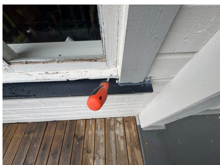
Råteskade i vinduet.
