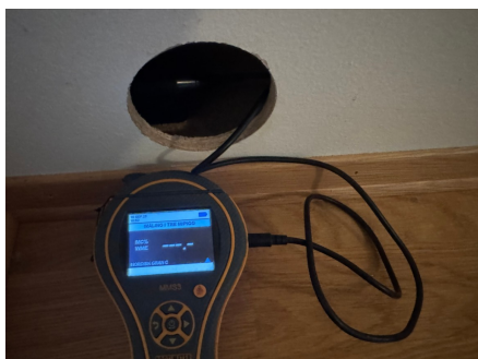
Fuktmåling mot vaskerommet.
