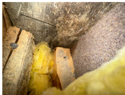
Det er tegn til fuktskjolder innvendig i veggen.
