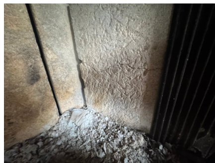
Sprekk i ildfast stein i ildstedet.
