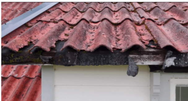
Skader på taktekingen.
