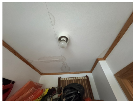
Fuktskjolder i taket på boden.
