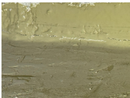
Sprekk i overgangen mellom vegg og gulv.
