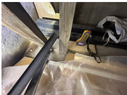
Fuktmåling i lagrede materialer på gulvet ved synlig fuktighet.
