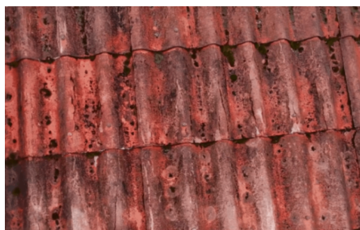
Sprekker i taktekingen.
