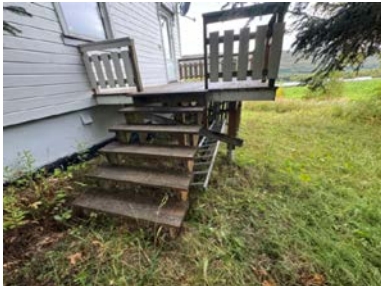
Det er ikke rekkverk i trappen.
