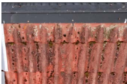
Sprekker i taktekkingen.
