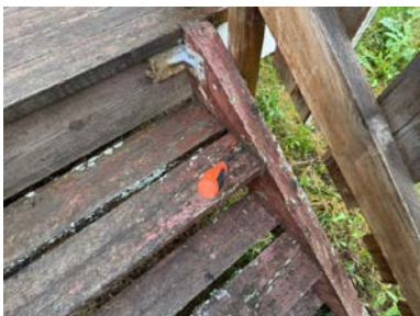
Råteskade i trappen.
