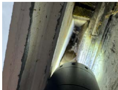
Det er ikke montert musesperre bak deler av kledningen.
