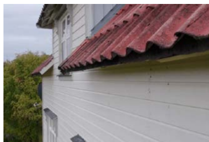
Det er ikke montert takrenner på nedsiden av boligen.
