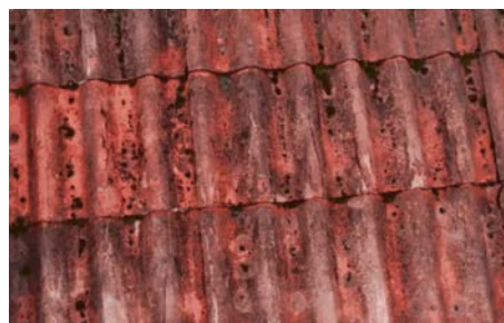
Sprekker i taktekkingen.
