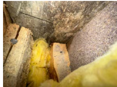
Det er tegn til fuktskjolder innvendig i vegg.
