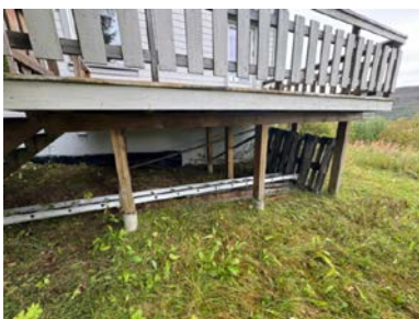
Utvendig fuksikring er avsluttet midt på veggen.
