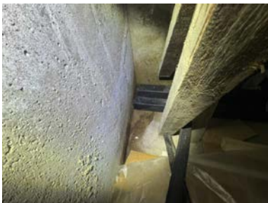
Synlig fuktighet i kjelleren.
