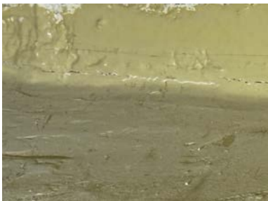
Sprekk i overgangen mellom vegg og gulv.
