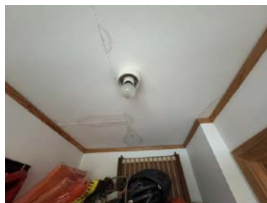
Fuktskjolder i taket på boden.
