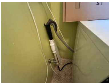
Det er ikke tettesjikt på veggene i våt sone.
