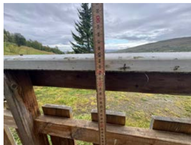
Høyden på rekkverket.
