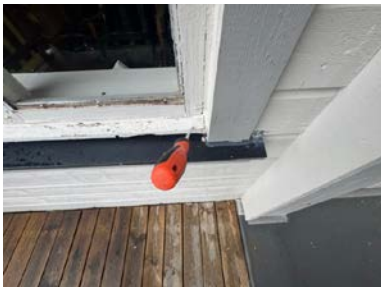
Råteskade i vinduet.
