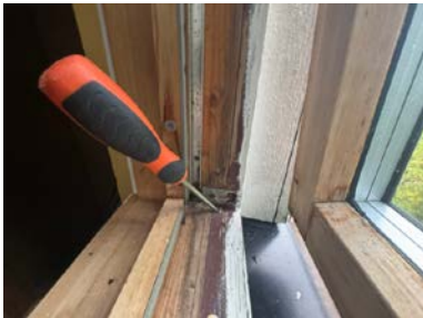
Råteskade i vinduet.
