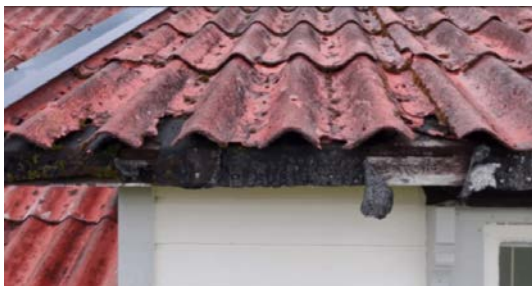
Skader på taktekkingen.
