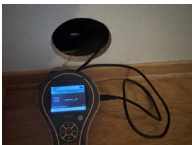
Fuktmåling mot vaskerommet.
