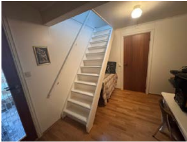
Det er ikke montert rekkverk på trappen opp til loftet.
