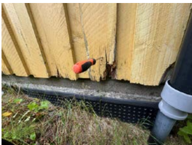
Råteskader i kledningen.
