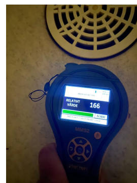
Indikasjonssøk etter fukt foretatt i overflaten rundt sluken.,
