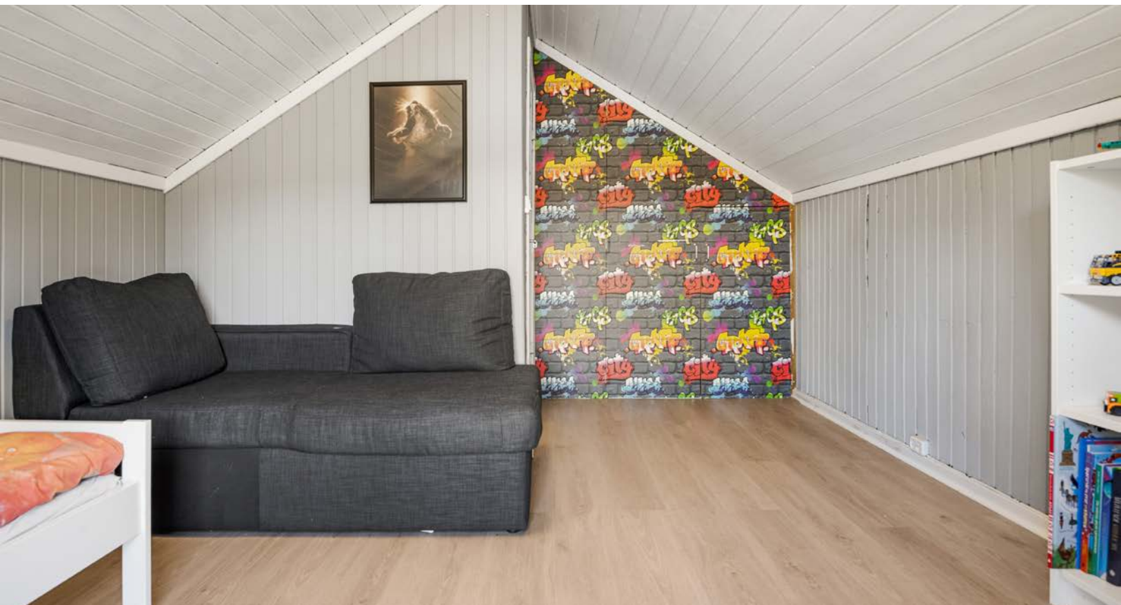
Rom innredet som soverom på loftet. Det er ikke mottatt byggetegninger, og man har dermed ikke kunnet kontrollere om rommene på loftet er godkjent for varig opphold.
