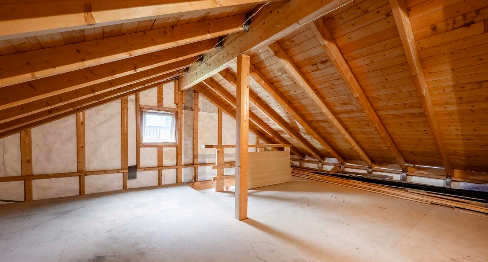
Garasjen har loft med adkomst via innvendig trapp - Loftet har 19 m 2 bruksareal og gulvareal på 61 m 2
