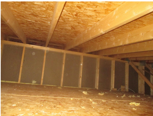
Kaldtloft over lagerrom i andre etasje.
