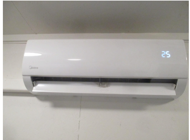
Varmepumpe på møterom.
