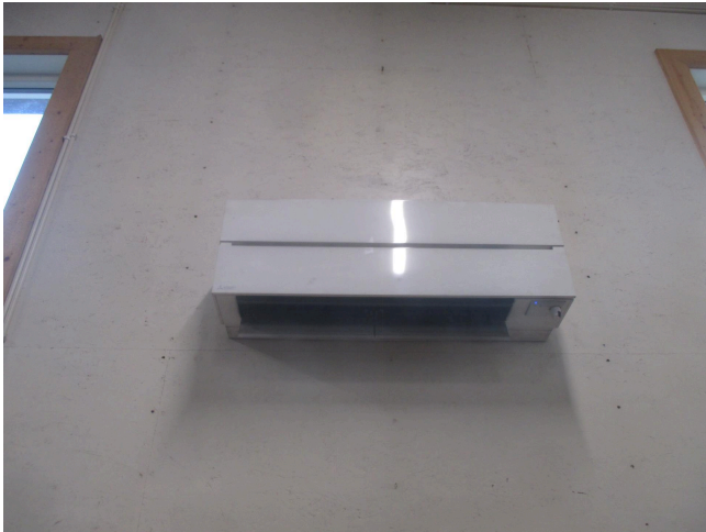
Varmepumpe i verksted/lagerhall.
