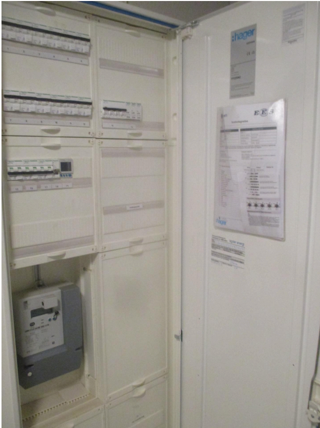
Stort sikringskap er plassert på teknisk rom.
