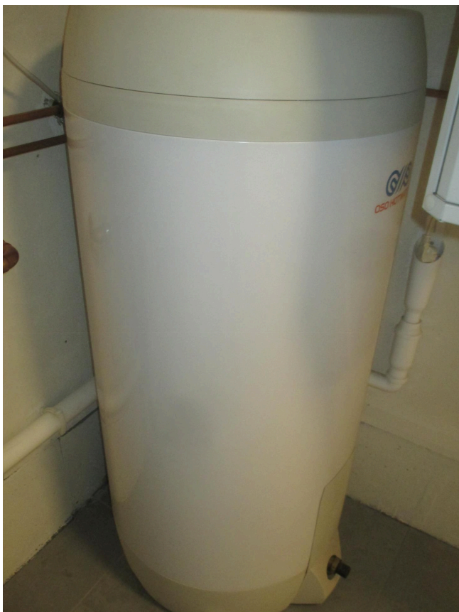
Bereder på ca 200 liter på teknisk rom.
