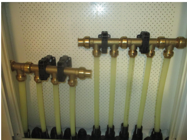
Fordelerskap for rør i rør system.
