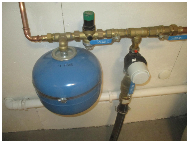
Innvendig stoppekran med vannmåler
