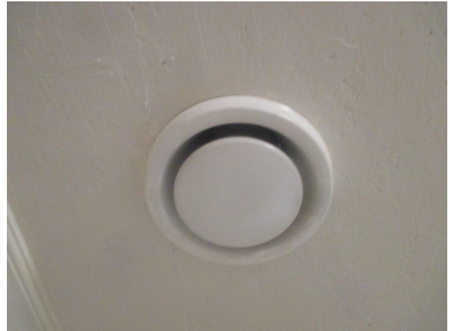
Avtrekk i himling for ventilasjon av rommet.
