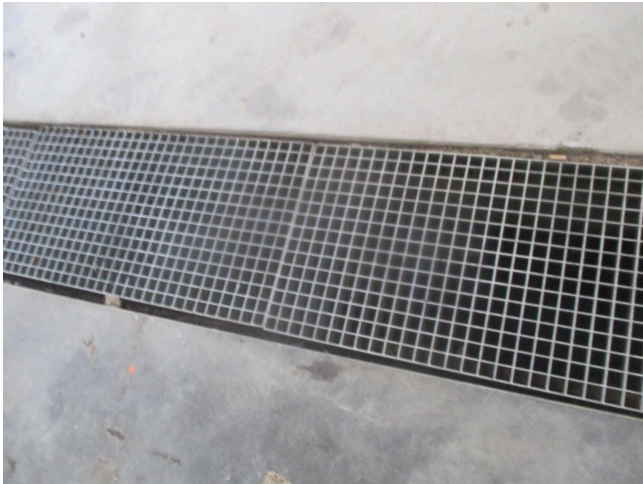
Renne i gulvet som føres til en oljeutskiller.
