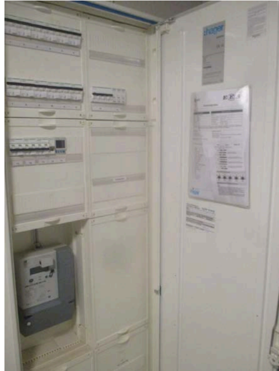
Stort sikringskapp er plassert på teknisk rom.
