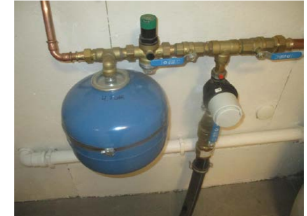
Innvendig stoppekran med vannmåler
