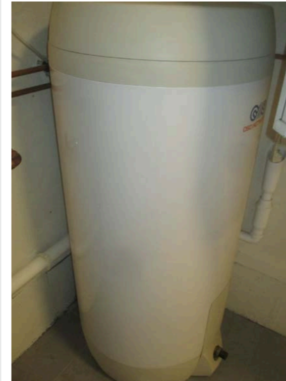
Bereider på ca 200 liter på teknisk rom.
