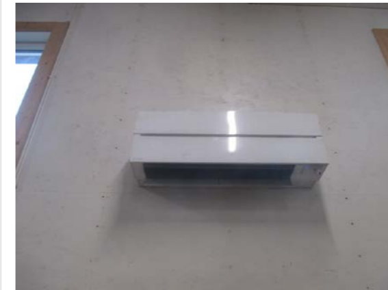
Varmepumpe i verksted/lagerhall.
