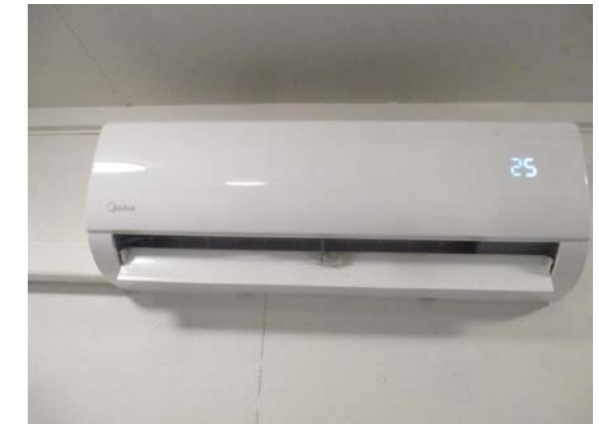
Varmepumpe på møterom.
