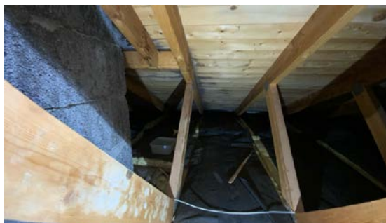
Synlig svertesopp på deler av undertak der saneringsvask bør utføres.
