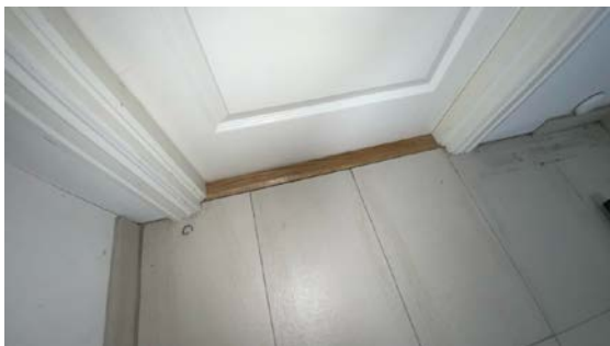
Luftespalte på dørblad bør opparbeides.
