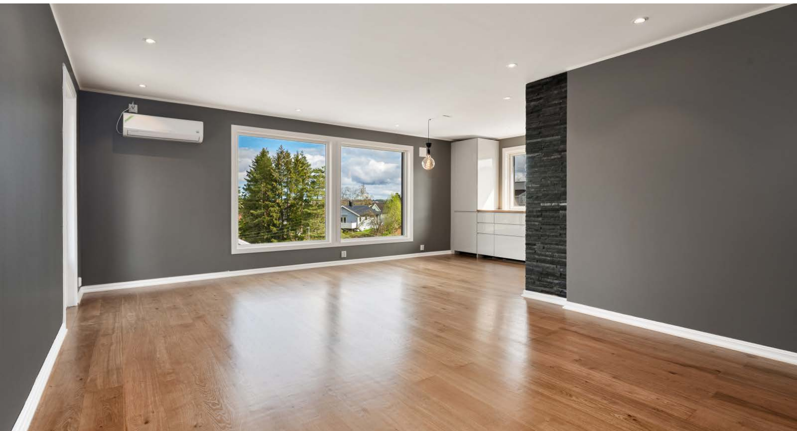
Det er montert varmepumpe.
