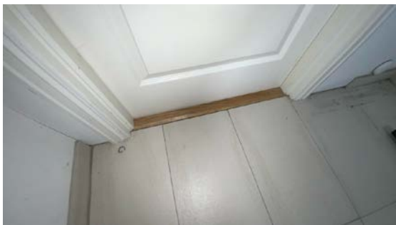
Luftespalte på dørblad bør opparbeides.
