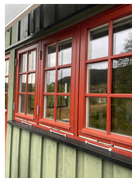
Påbegynt værslittasje utvendig
