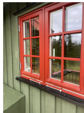
Påbegynt værslittasje utvendig
