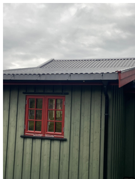
Enkelte fasader med værslitte overflater/sprekker i treverk.
