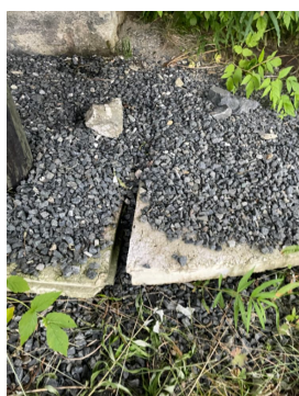
Plastisolasjon med manglende tildekking og ufaglig montering
