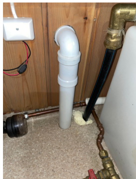
Ufaglige rørgjennomføring i våtsone gulv.
