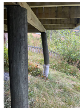
Skeivhet i bærende søylepunkt med fare for ytterligere skadevirkning om tiltak ikke igangsettes.
