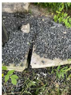
Plastisolasjon med manglende tildekning og ufaglig montering
