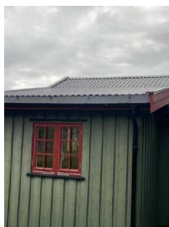
Enkelte fasader med værslitte overflater/sprekker i treverk.
