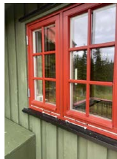
Påbegynt værslitasje utvendig
