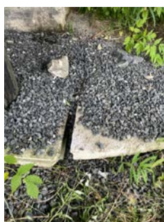
Plastisolasjon med manglende tildekning og ufaglig montering
