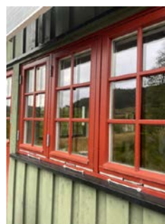
Påbegynt værslitasje utvendig
