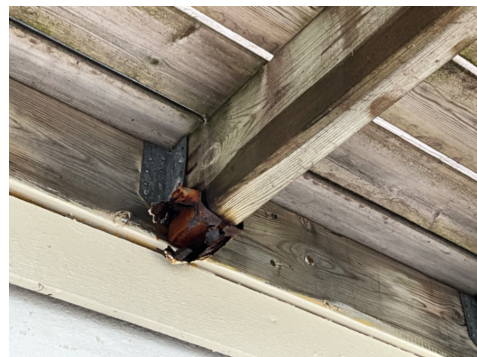
Altan med utgang fra soverom; rustet bjelkesko.
