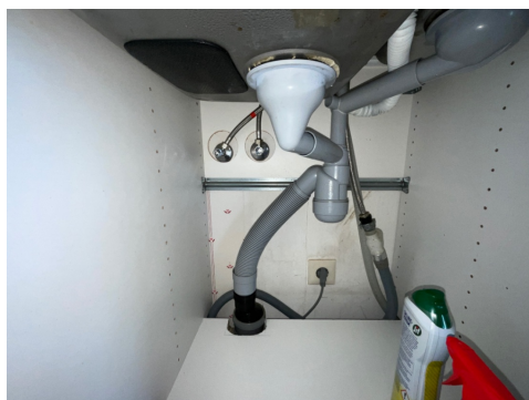
Hovedetasje: Røropplegg under kjøkkenvask.
