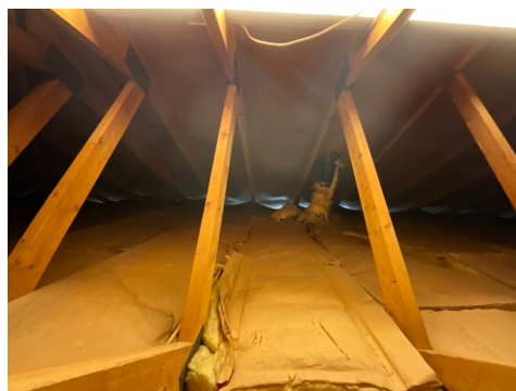
Synlig lufting i raft/ kiste.
