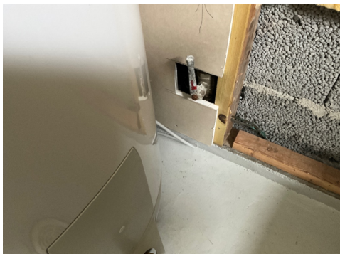
Hovedstoppekran ved varmtvannstank. Irr i området håndtak.
