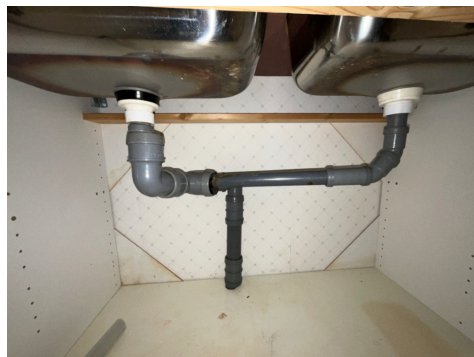
Hovedetasje: Røropplegg under skyllekum, vaskerom.
