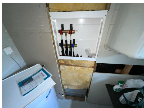
Rørskap/ fordelerskap (plastrør/ rør-i-rør), montert på vaskerom. Drenshull/ «siklemikk» under skap.
