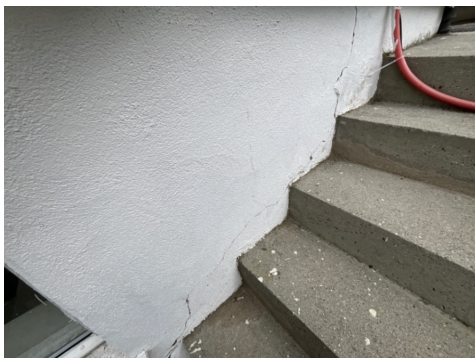
Sprekker/ riss i grunnmur, sørøst.
