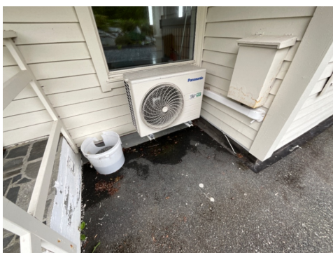
Varmepumpeaggregat montert på yttervegg i området trappeløp.
