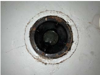
Plastsluk mot betongdekke.
