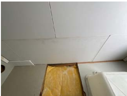
Merker etter tidligere lekkasje fra bad, overetasje. Utbedret via forsikring.
