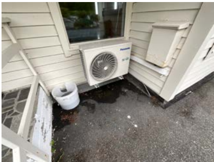
Varmepumpeaggregat montert på yttervegg i området trappeløp.
