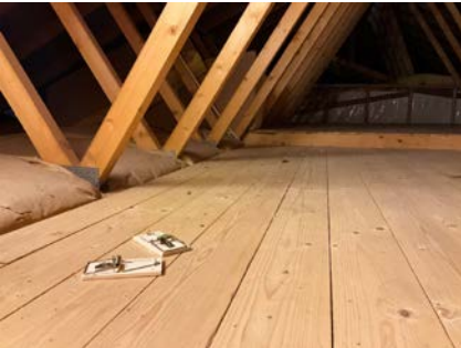
Musefeller på loft. Eier har også montert «lydskremmere», (små apparater som plugges i støpsel. Høyfrekvente lyder skremmer mus/ gnagere. Det mte ikke registrert muselort på befaringen
