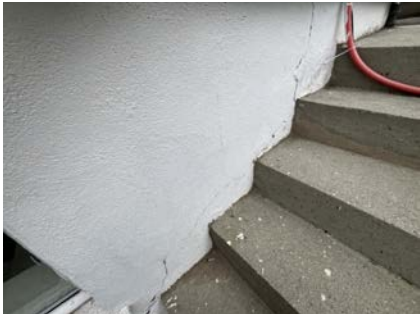
Sprekker/ riss i grunnmur, sørøst.
