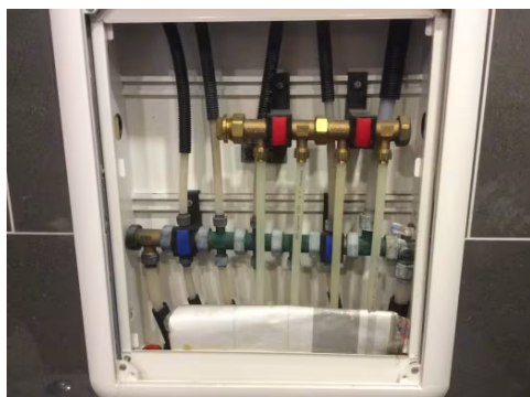
Vannfordelerskap i underetasje. Plassert på bad.
