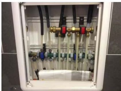
Vannfordelerskap i underetasje. Plassert på bad.
