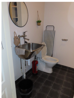
Vaskerom/toalettrom, kombinert rom med tekniske installasjoner.
