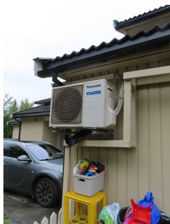
Luft til luft varmepumpe fra byggeår.
