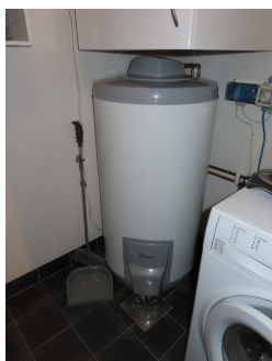
200 liters varmtvannsbereder inne på vaskerommet.
